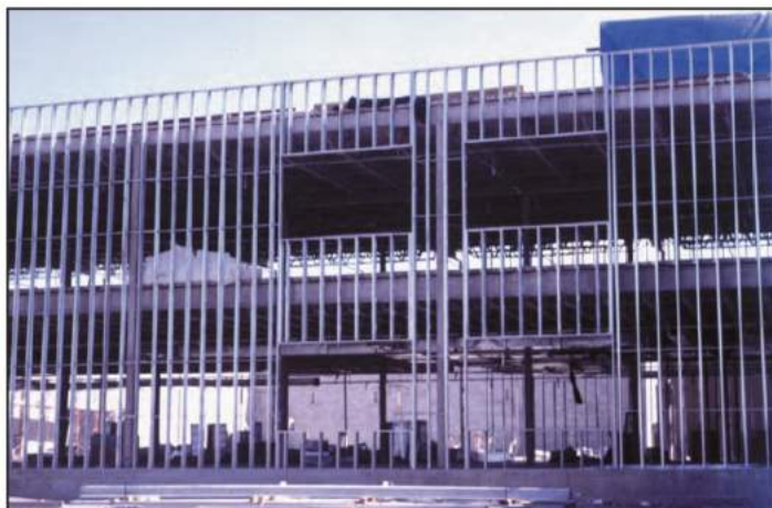
شکل ۵-۳۴- پشت‌بند قائم فولادی در ساختمان‌های یک یا دو طبقه با قاب‌های سازه‌ای فولادی برای اجرای نما
